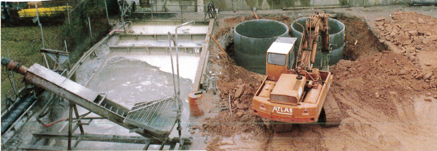
1 Herkömmliche Recyclinganlage (links) und vorbereitende Installation der Sammelbehälter. 2 Waschplatz mit Gefälle. 3 Pumpleitung von der Fräskopf-Baggerpumpe zur Recyclinganlage.
